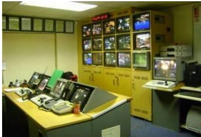
Maison Dieu CCTV Control Room
